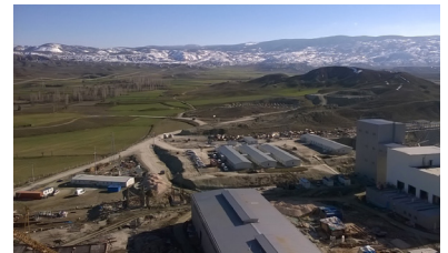
Yunus Emre Coal Fired Power Plant, Mihalıççık-ESKİŞEHİR, Türkei, Kohlekraftwerk
